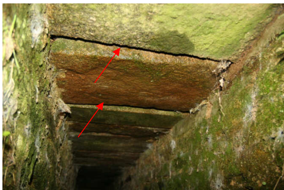
Figure 11 : dalles de pierre d'un pont dalot (photo : Julien Sudraud)
