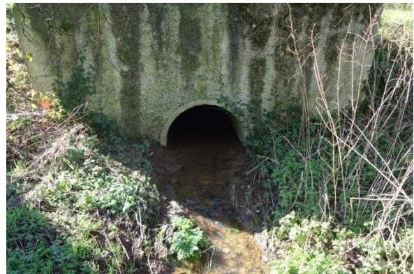
Figure 10 : buse défavorable du fait du faible tirant d'air (photo : Etienne Ouvrard)
