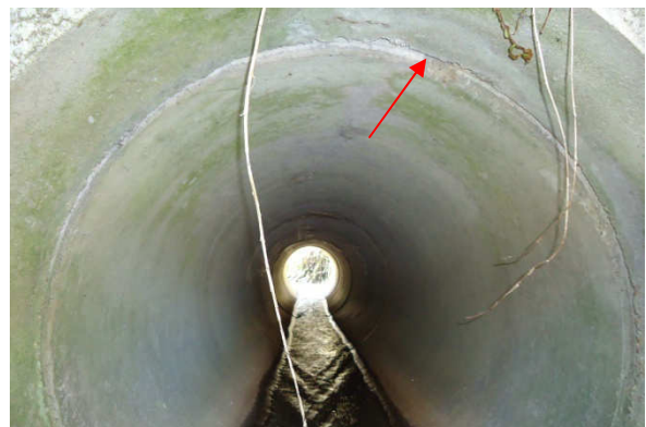
Figure 7 : buse. Les chiroptères se tiennent dans l'interstice entre les différents éléments (photo : Etienne Ouvrard)
